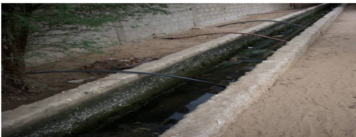
Photo 8 : Canal à ciel ouvert alimentant les vergers et champs de Khor-Bango
