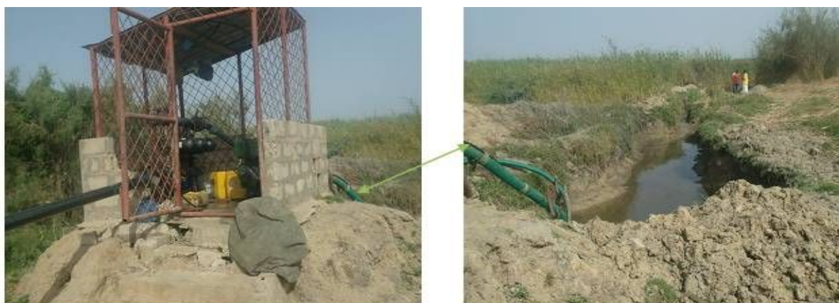
Photo 11 : Canal alimentant la station de pompage du village de Ndiawdoune Naar (source : Kamara, 2008)
