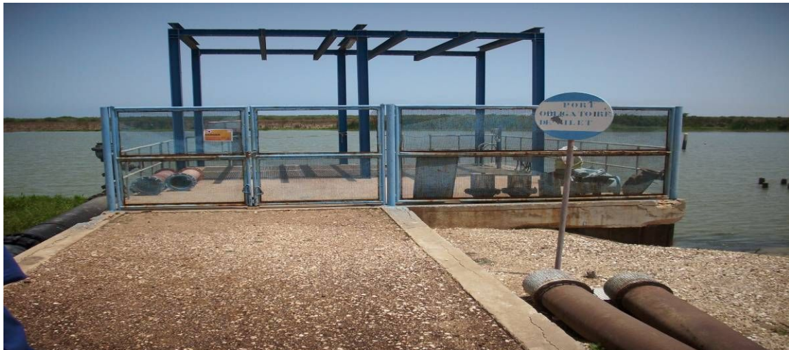
Photo 6 : Station de pompage de la SDE installée dans la réserve de Bango
