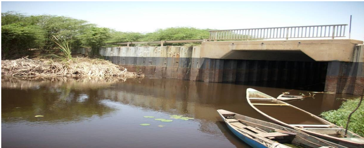
Photo 4: Couleur noirâtre de l'eau au niveau du pont de Mboubène
