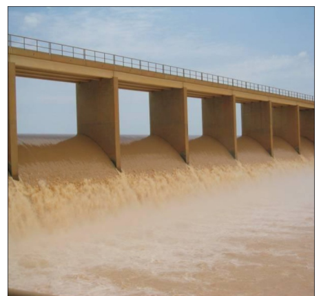
Déversement - Barrage de Ziga © Boureima Nebie
